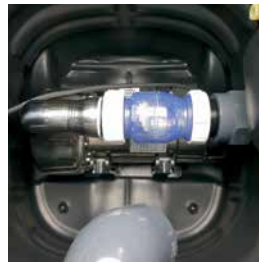
Rückschlagventil RSK und Entleerungspumpe
