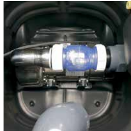
Rückschlagventil RSK und Entleerungspumpe
